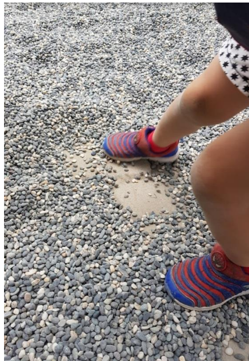
圖 6 礫石厚度不夠且底層為混凝土之遊戲場
